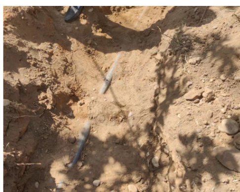
10kv 电缆损坏
