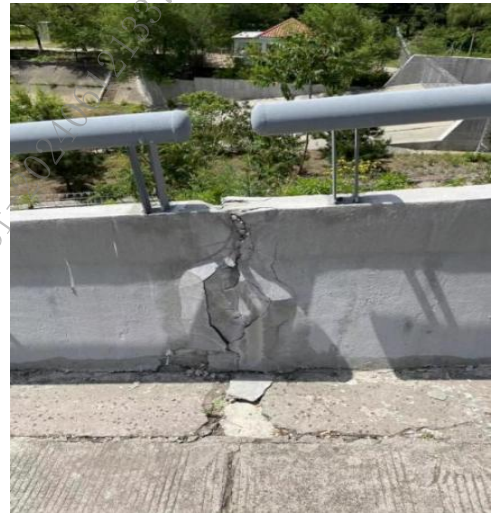
路边挡墙破损现状
