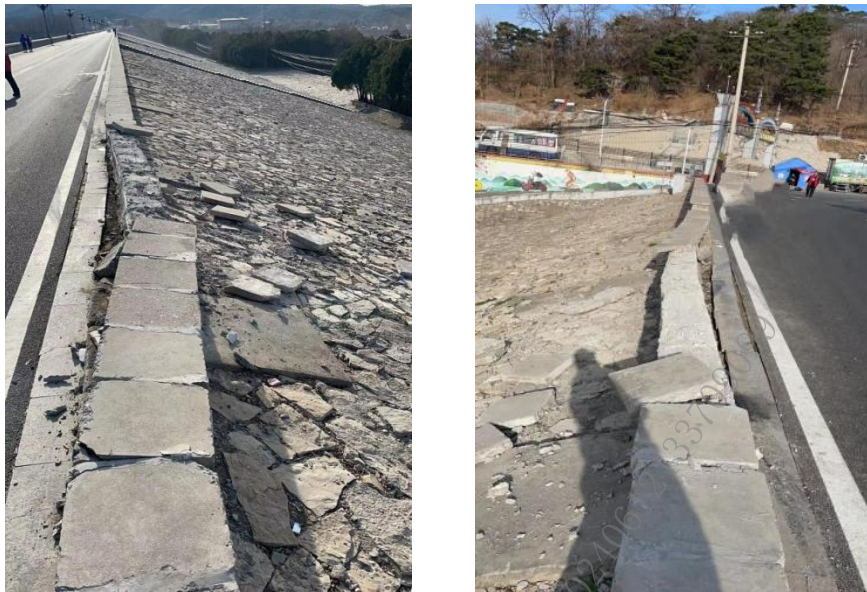
南石骆驼副坝碰撞后
