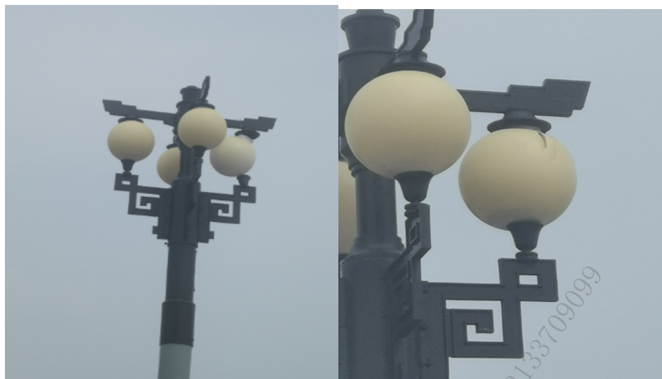
坝上灯具现状
