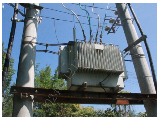
内湖变压器现状
